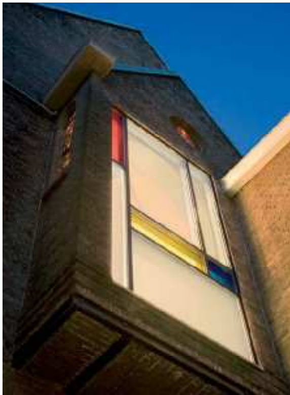
Alleen bij de altaargevel is de relatie met de buitenwereld gelegd door middel van een asymmetrisch, op Mondriaan geïnspireerd raam
